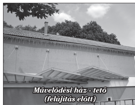
Művelődési ház - tető (felújítás előtt)
